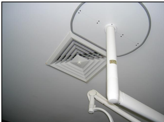
Üblicher Drallauslass für Zuluft, hier im OP-Saal.
